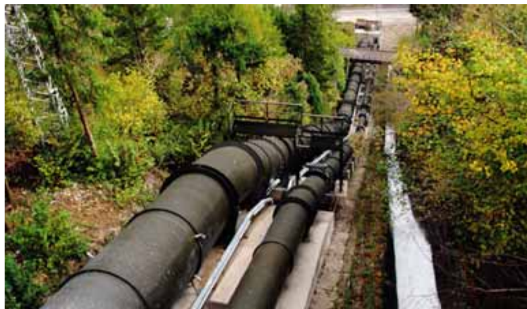
Una condotta idroelettrica nelle nostre valli: i Comuni chiedono maggiori introiti Ici da questi impianti
