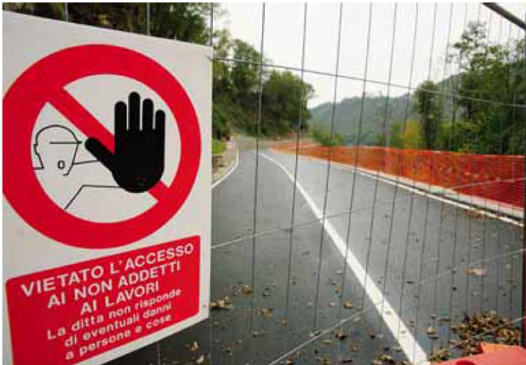
La nuova strada Ambria-Camanghè come si presentava due anni fa allo stop dei lavori
