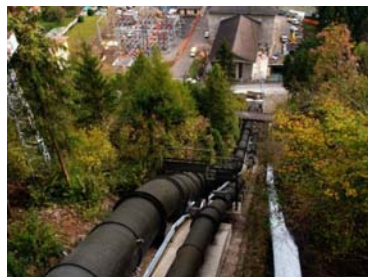
Condotte di centrale idroelettrica
